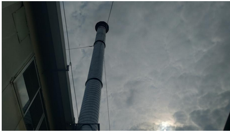
项目有组织废气排放口图片
