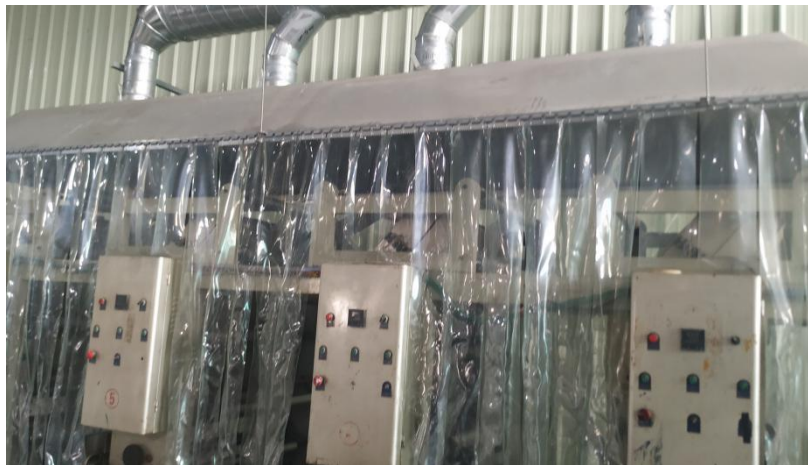
项目有组织废气收集设施图片1
