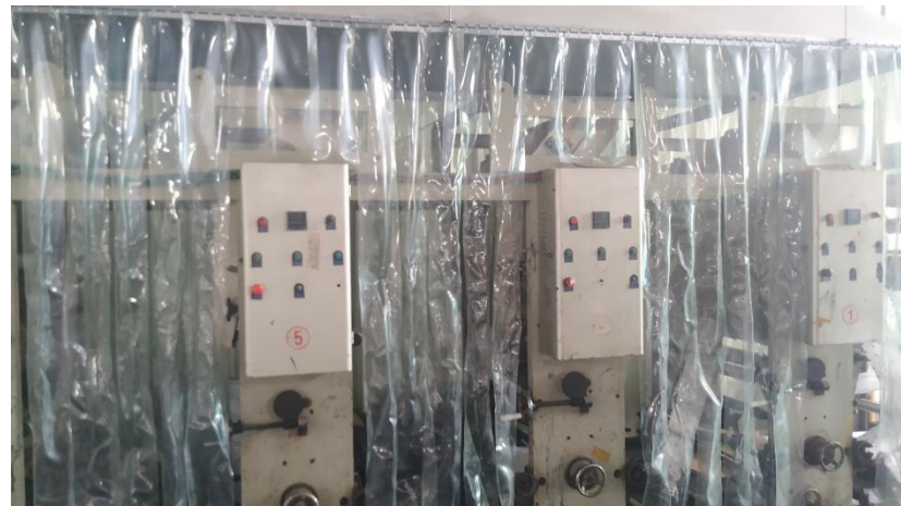
项目有组织废气收集设施图片2
