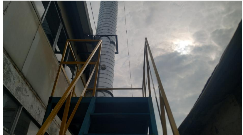
项目有组织废气排放口采样口及监测平台图片
